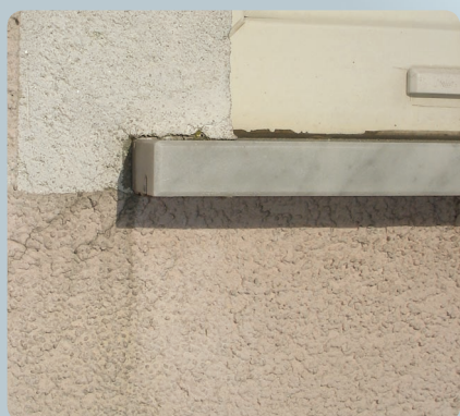
Kamnite police brez zaključkov - voda teče po fasadi in pušča sled.
